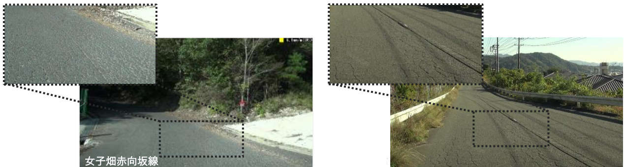
ひび割れの発生状況
