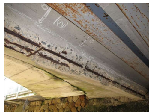
主桁のうき・剥離・鉄筋露出
