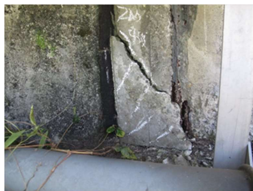
主桁のうき・剥離・鉄筋露出
