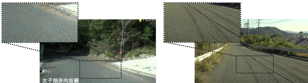
ひび割れの発生状況
