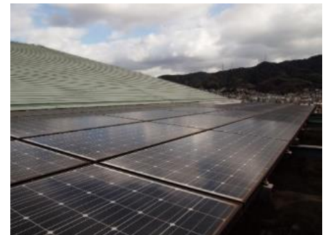
市役所屋上太陽光パネル
