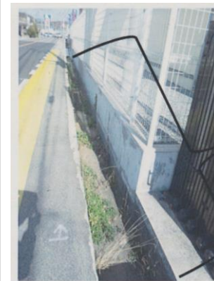
25-4:側溝に落下の危険性がある
