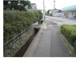
R3-11 :側溝に落下の危険性がある
