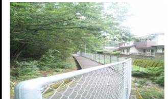
26-17 : フェンスが一部破損しており危険
