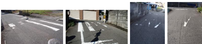
26-1: 横断歩道, 路面標示等が消えかかっており危険
