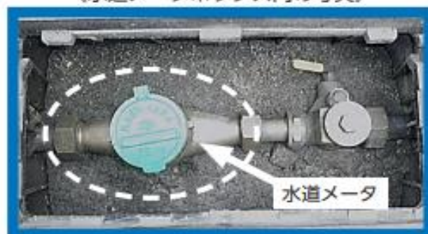
《水道メータボックス内の写真》
