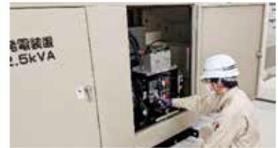
放射温度計を使った自家発電設備の点検
