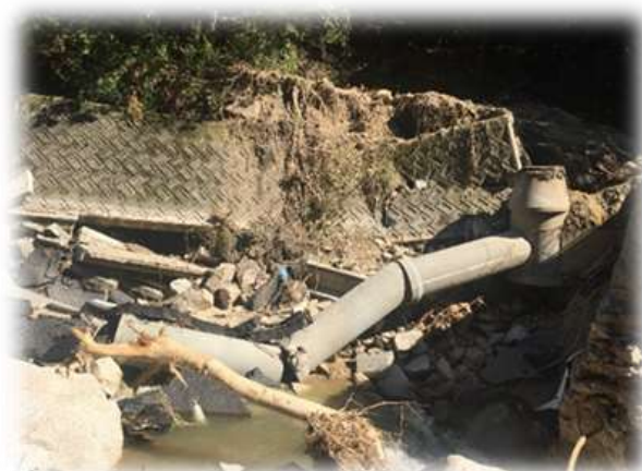
天応焼山污水幹線（下水道）
