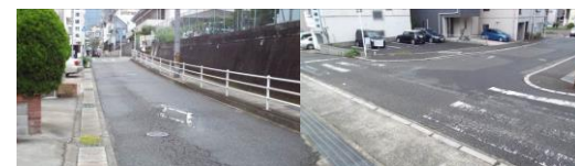
26-5: 横断歩道, 路面標示が消えかかっており危険
