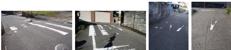
26-1: 横断歩道, 路面標示等が消えかかっており危険
