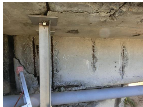
主桁の剥離・鉄筋露出
