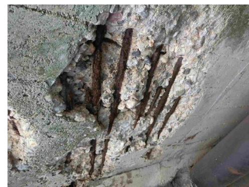
コンクリート床版の剥離・鉄筋露出
