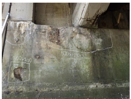
橋台の剥離・鉄筋露出
