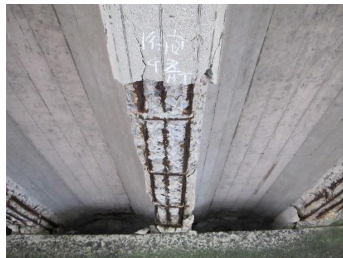
主桁のすき・剥離・鉄筋露出
