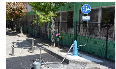
緊急時給水栓（阿賀中央公園）
