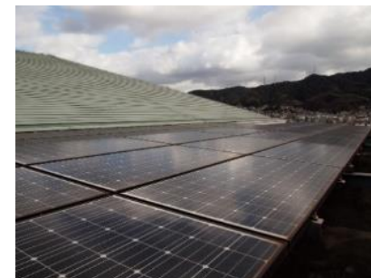
市役所屋上太陽光パネル
