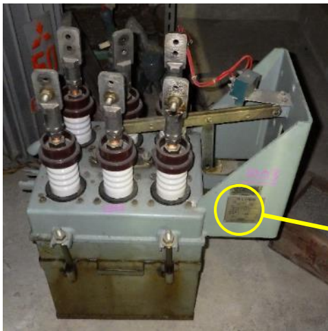
遮断器 (油入遮断器)
