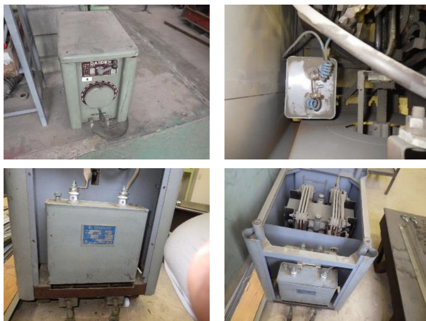
写真 3 電気溶接機に設置された低圧コンデンサー
