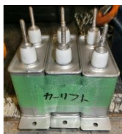
写真5 カーリフトに設置されたコンデンサー
