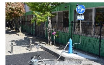
緊急時給水栓（阿賀中央公園）
