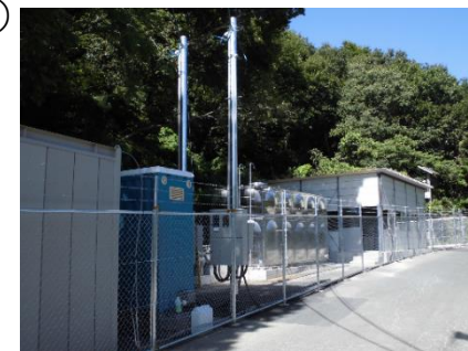
柳迫第1ポンプ所（仮設）
