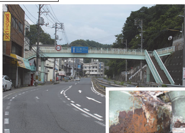
原横断歩道橋 健全度Ⅲ
