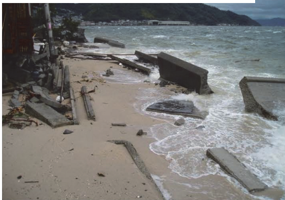
呉海岸天応地区 平成16年被災状況
