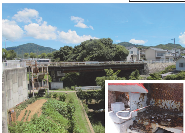
勤住橋 健全度Ⅲ
