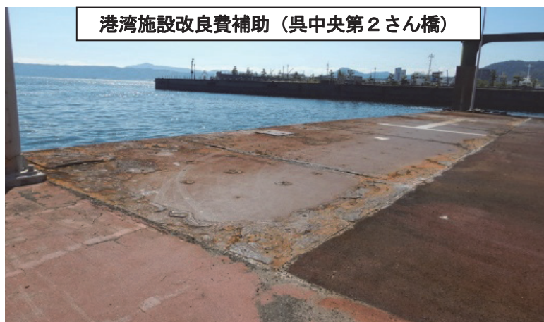
敷鉄板損傷状況
