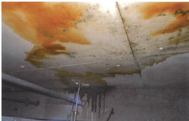
防災改修等支援事業 ※屋上の防水機能喪失 による天井内雨漏り
