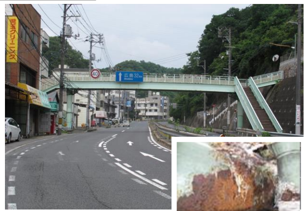
原横断歩道橋 健全度Ⅲ
