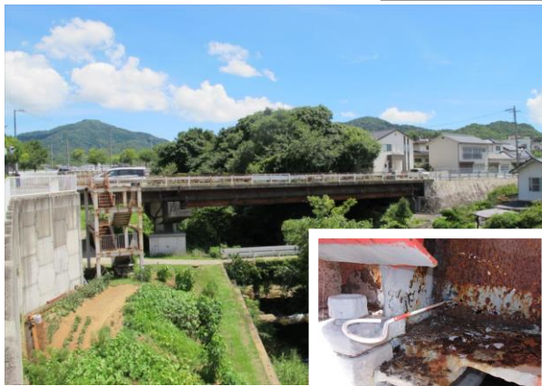
勤住橋 健全度Ⅲ
