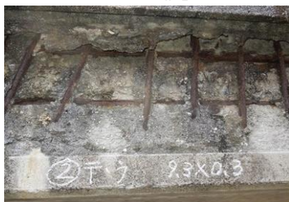
【建設後 50 年以上が経過し老朽化により 鉄骨が露出した「中田橋」（新開・小塚線）】
