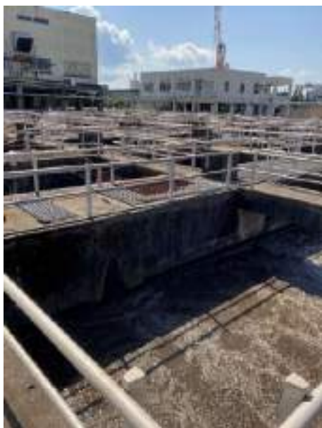
[エアレーションタンク]
