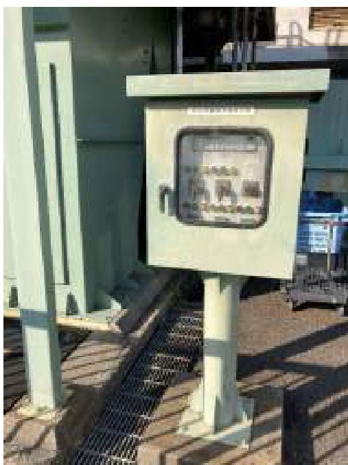
[除塵機操作盤]
