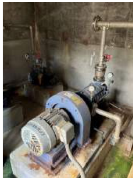
[処理水送水ポンプ]
