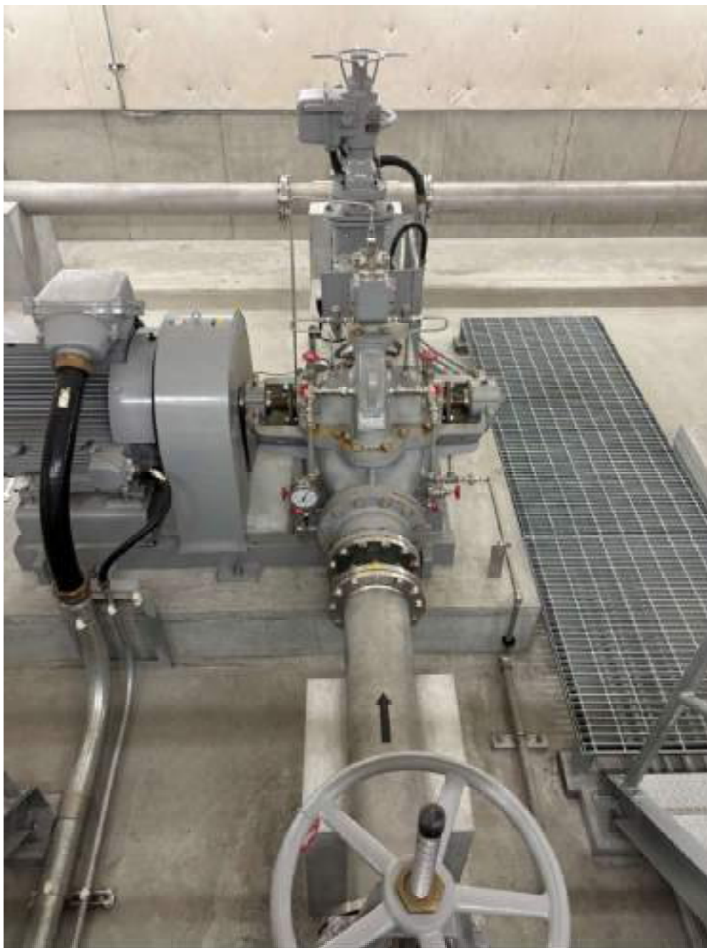
(平原高区ポンプ所)
