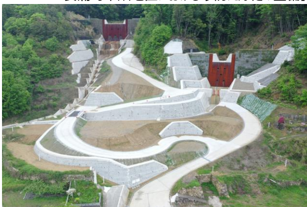
【平成30年7月豪雨で被災した 安浦町中畑地区における砂防えん堤の整備】
