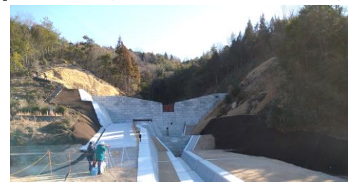
【国直轄砂防事業 背戸の川砂防施設（天応地区）】
