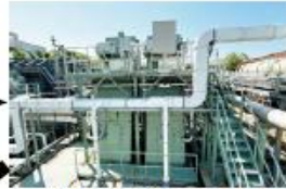
▲砂やごみを取り除く設備
