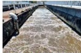
▲汚水の汚れを取り除く設備
