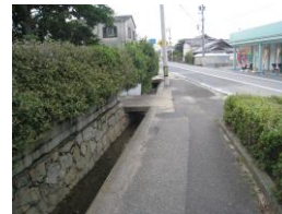
R3-11 :側溝に落下の危険性がある
