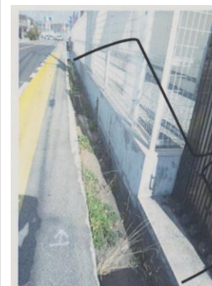
25-4:側溝に落下の危険性がある
