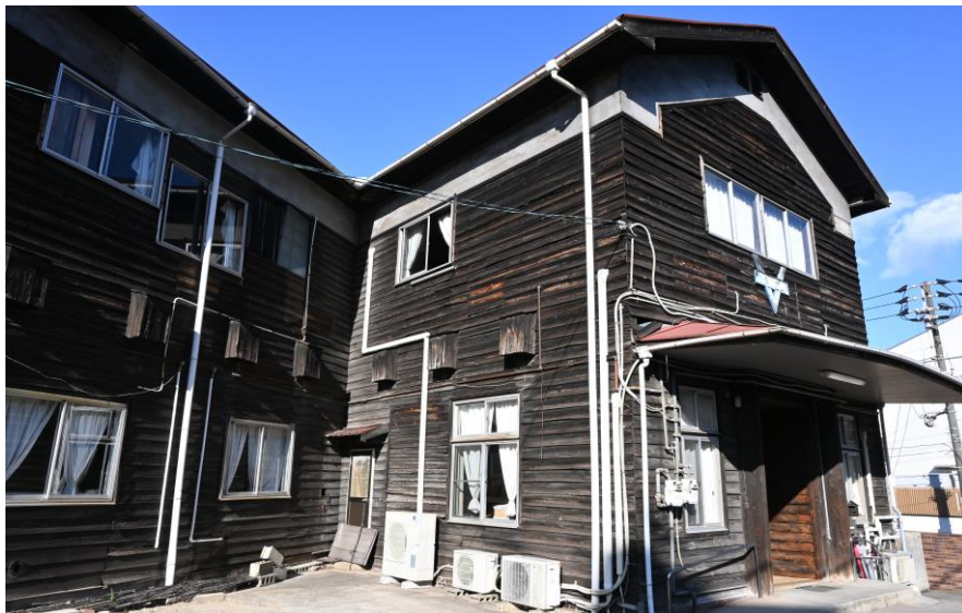
0 4 建物屈曲部（南から）
