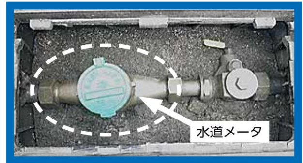
《水道メータボックス内の写真》
