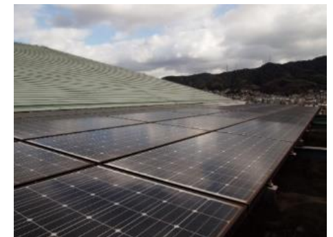
市役所屋上太陽光パネル
