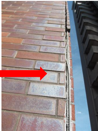
レンガが剥離した部分
