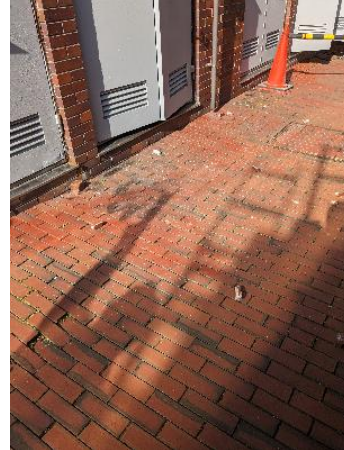
通路に落下したレンガ
