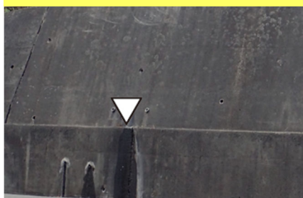
地下水の流出
