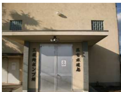
○三坂地ポンプ所（広島地区） 昭和31年築造
