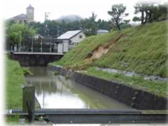
三永水源地 取水口
