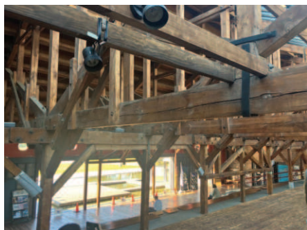
写真3. オープンスペースは、小屋組みを可能な限り保存・補強した
