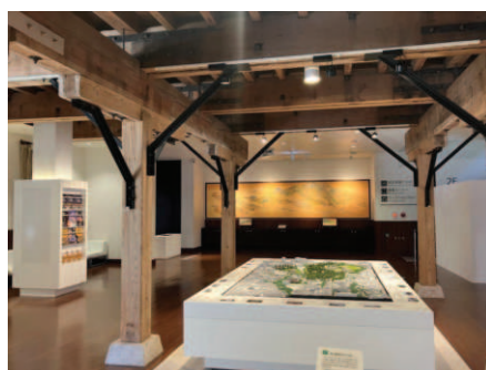
写真4. 第2棟は鉄骨で補強されている
