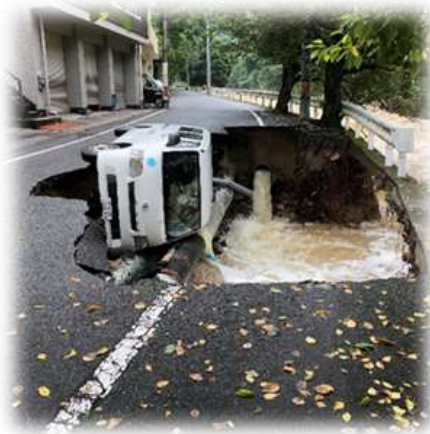
二河川焼山污水幹線（下水道）
