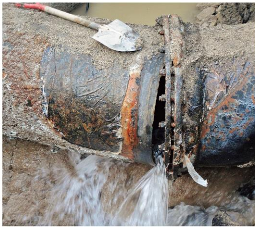
▲継手が抜けた水道管
